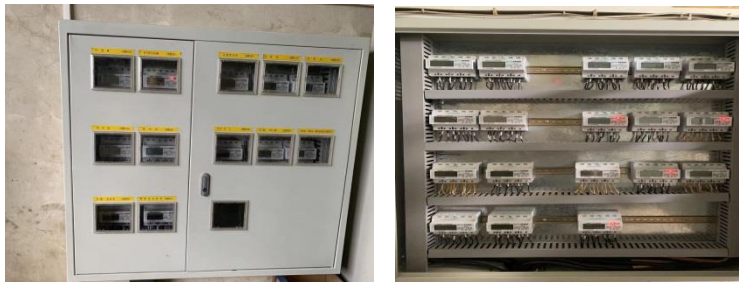
共和興の各工程に設置した電力計
