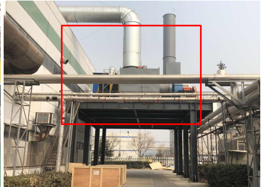
(排ガス処理装置)
